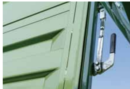
Metal labyrinttætning på hjørnestopler og overbygning.
