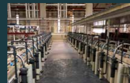
KTL & předúprava 12 ponorných procesů pro chemické čištění a následné KTL nátěry
